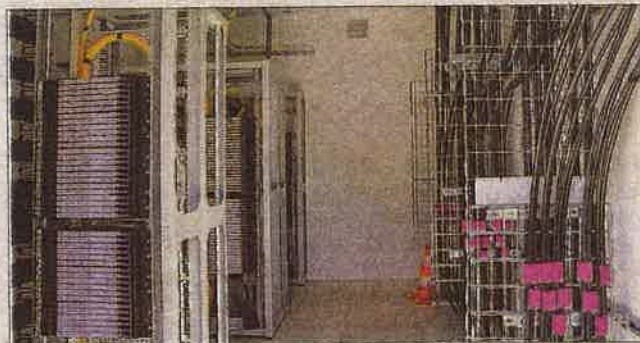
Une partie du local technique NRO (Nœud de raccordement Optique) accueillant les équipements des opérateurs.
